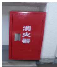
⑪ 消火器ボックス
