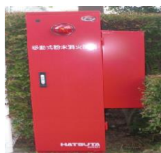
⑫ 屋外消火器ボックス
