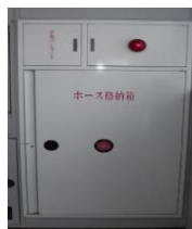
⑭ 連結放水口
